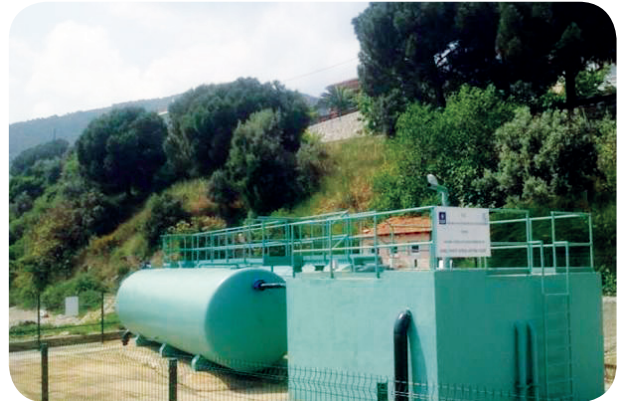
Narlı Paket Atık Su Arıtma Tesisi
