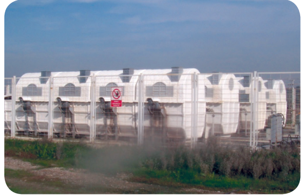
Hasanağa Paket Atık Su Arıtma Tesisi
