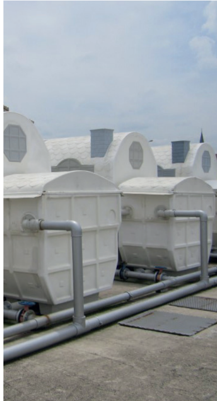
Atık Su Arıtma Tesisi
